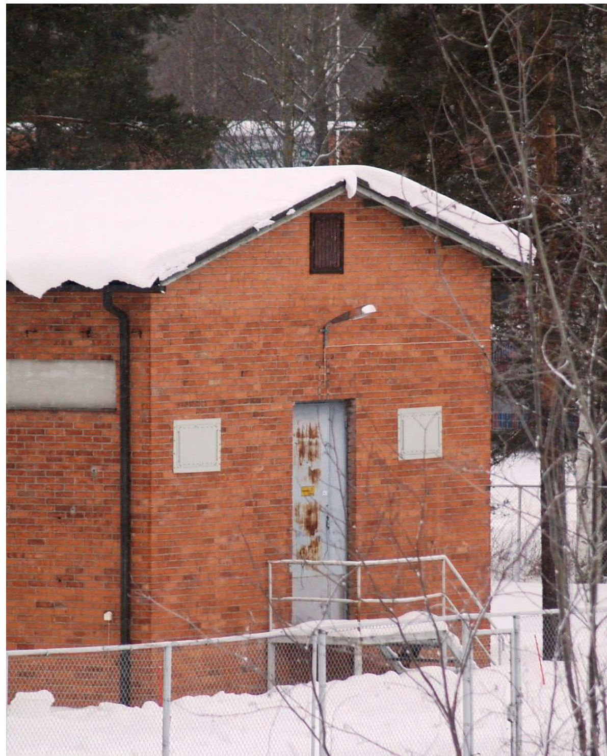
Siihtalan keskusmuuntamo v. 1950 903-20 (ent. 903-), Muuntamontie 4
