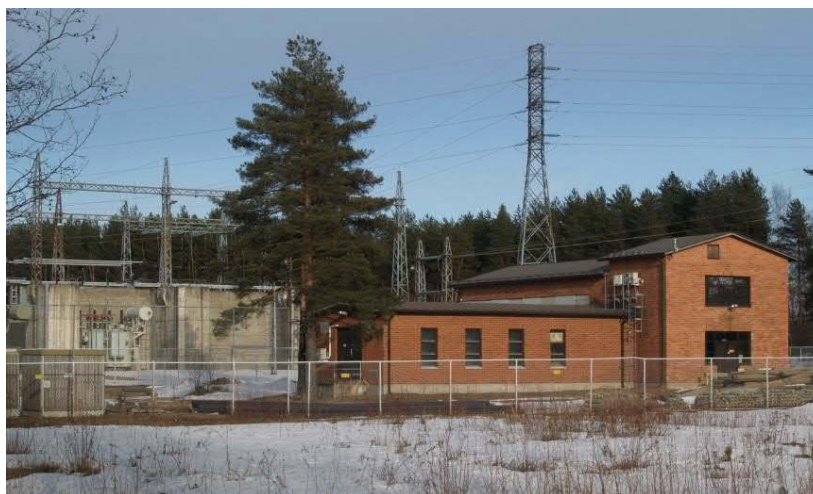
SIIHTALAN KESKUSMUUNTAMO 1950 - M. Välikangas
