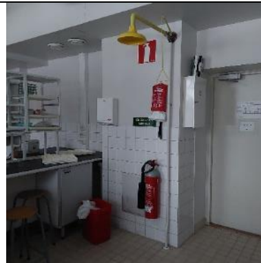
Kuva 74 hätäsuihku kemian luokassa
