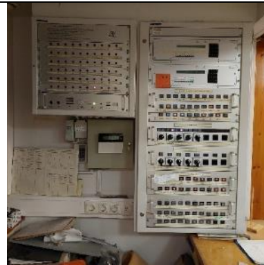
Kuva 105 osittain käytössä oleva hälytyskeskus ja valojen ohjauskeskus
