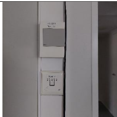
Kuva 108 terveydenhoitajan tiloissa huonelämpötila-anturi ja ilmastoinnin käyttökytkimet
