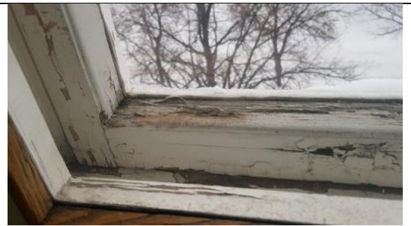
Kuva 18: Ulkopuite korjauksen tarpeessa
