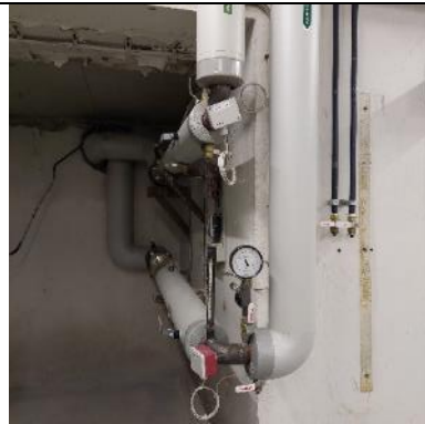
Kuva 99 antureita, mittareita kaukolämpöjohdoissa
