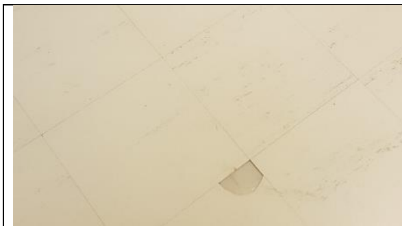
Kuva 43: Kellari, vinyylilaatta, asbestia
