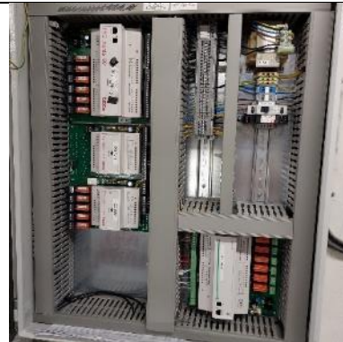
Kuva 103 Xenta-alakeskus VAK03, lämmönsiirtimet
