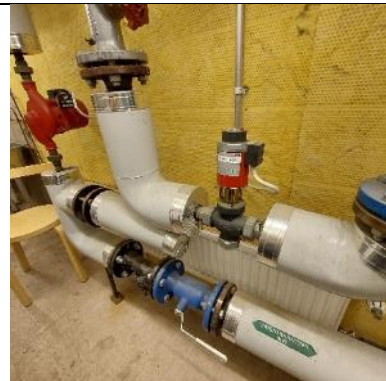
Kuva 57 iv-koneen säätöryhmä iv-konehuoneessa
