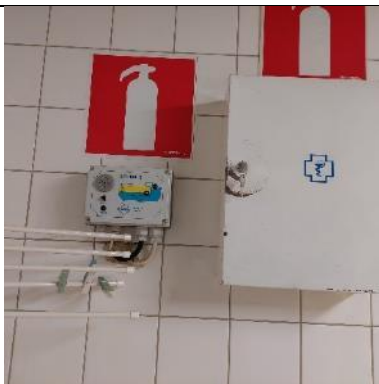
Kuva 75 keittiön rasvanerotimen hälytyslaite
