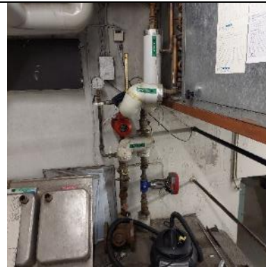
Kuva 100 keittiön iv-koneen lämmityspatterin säätölaitteet
