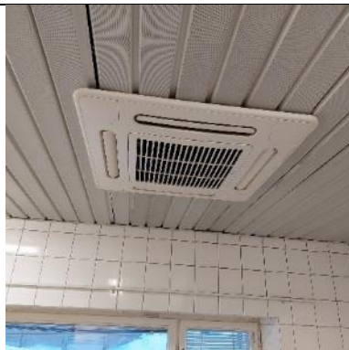
Kuva 93 Keittiön viilennyksen sisäyksikkö
