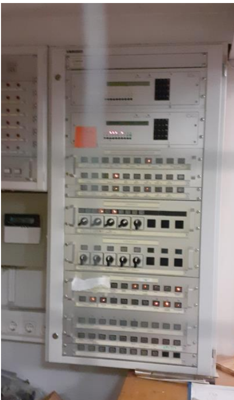
Kuva 5: Valaistuksen ja ilmanvaihdon ohjauskeskus
