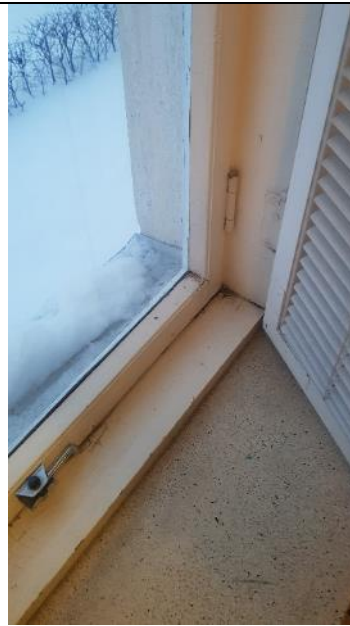
Kuva 15: Tuuletusikkuna toimii hy-
