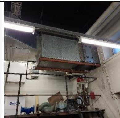
Kuva 78 keittiön tuloilmakone lämmönjakohuoneessa
