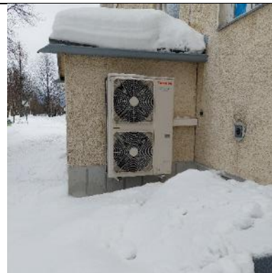
Kuva 94 Keittiön viilennyksen ulkoyksikkö
