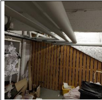
Kuva 76 hyväkuntoiset eristeet kellarikerroksessa
