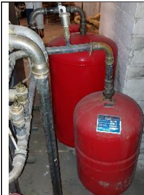
Kuva 74 iv-verkoston alkuperäinen ja uusittu paineastia
