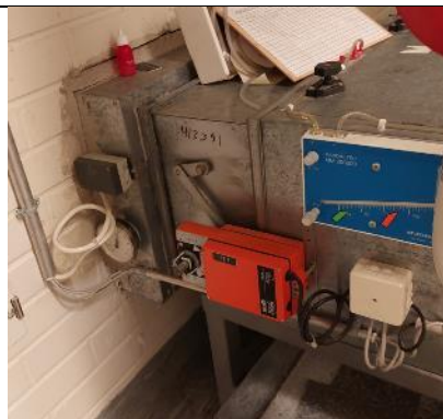
Kuva 108 matalan osan tuloilmakoneen toimilaitteita
