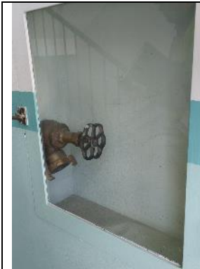
Kuva 121 portaikoista on poistettu pikapalopositit
