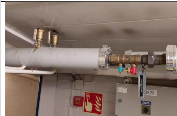
Kuva 78 esim. ilmanpoistimista ja säätöventtiileistä, matalan osan iv-verkosto/konehuone
