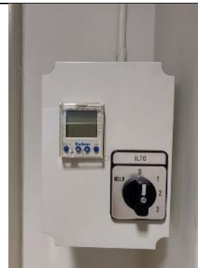
Kuva 129 4.kerrosken iv-tulo/poistoilmakoneen ohjaus/säätölaitteet
