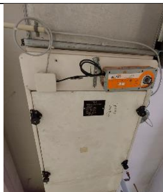
Kuva 110 tuloilmakone matalan osan kellarin katossa
