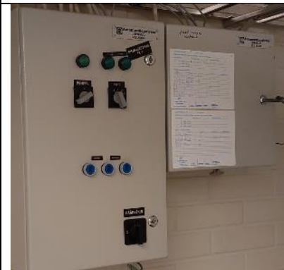
Kuva 130 matalan osan tuloilmakoneen ohjaus-säätökeskukset
