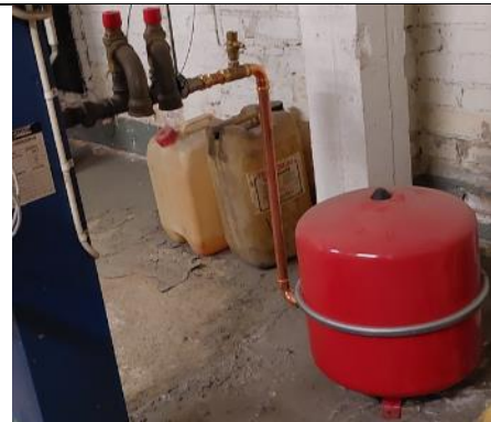
Kuva 75 lämmitysverkoston uusi paineastia
