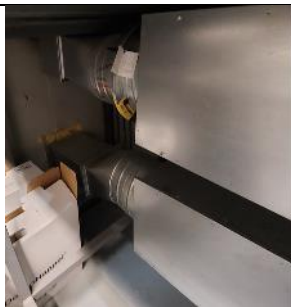
Kuva 114 uusia iv-kanavaosia / iv-kone 1-.3.krs
