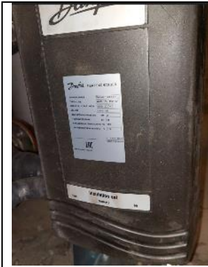
Kuva 71 arkiston lämm/ iv-lämmönsiirrin v.2020
