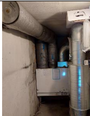
Kuva 106 4.kerroksen iv-kone ullakon komerossa, käynti portaikosta, hissikonehuoneen vieressä.
