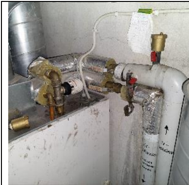
Kuva 76 iv-patterikytkennät 4.kerroksen tulo/poistoilmakoneella
