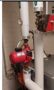
Kuva 77 iv-patterikytkennät matalan osan tuloilmakoneella
