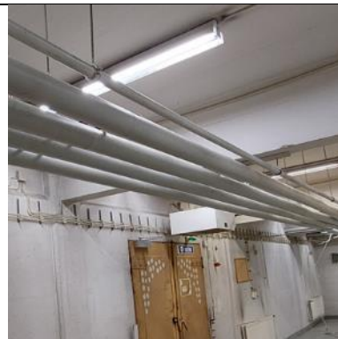
Kuva 79 lämpöjohtoja matalan osan kellarissa
