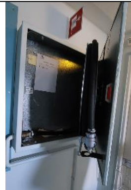
Kuva 122 remonteissa asennettu pikapaloposti
