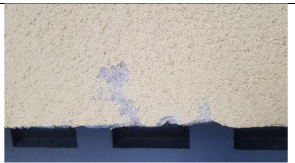
Kuva 26: Maalipinnassa paikallisia vaurioita
