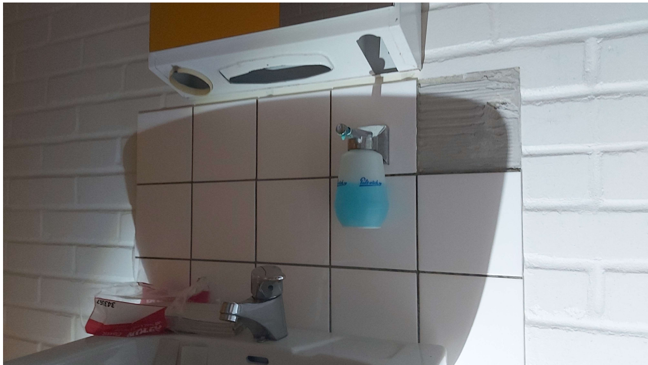
KUVA 3. Asbestinäyte nro 3, 11 WC Seinälaatan kiinnitys- ja sauma-aine. Sisältää asbestia.
