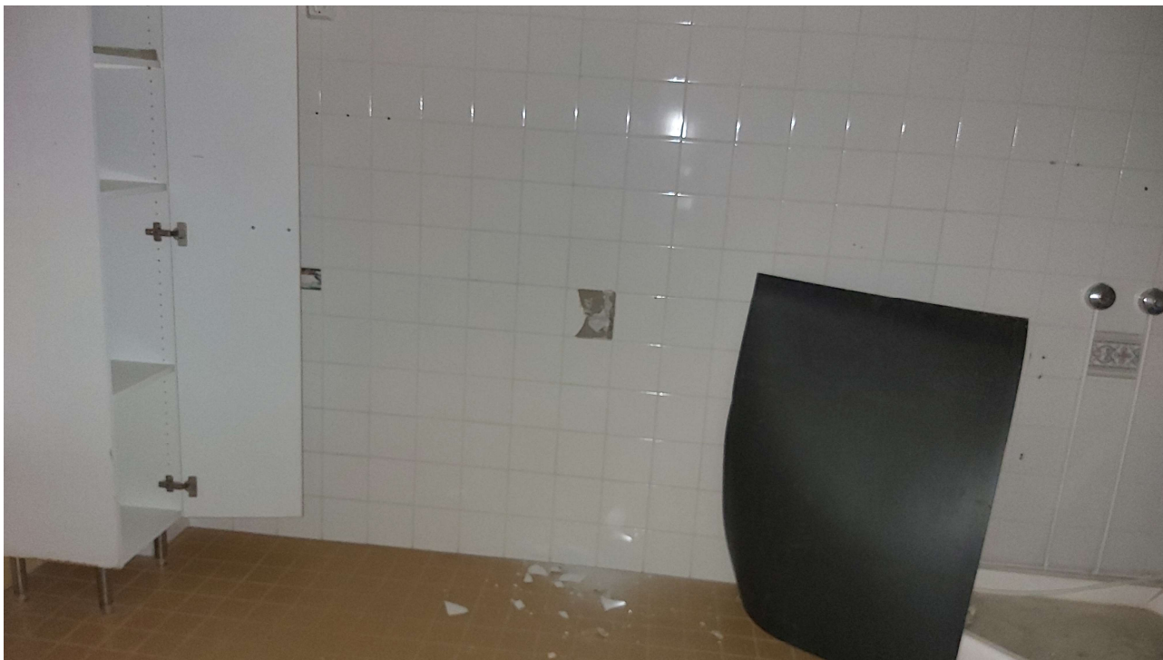
KUVA 7. Asbestinäytteet nro 7 ja 8, 34 Pesuh. Lattia- ja seinälaattojen kiinnitys- ja sauma-aineet + tasoitteet + kosteuseristeet. Ei sisällä asbestia eikä PAH-yhdisteitä yli sallitun.
