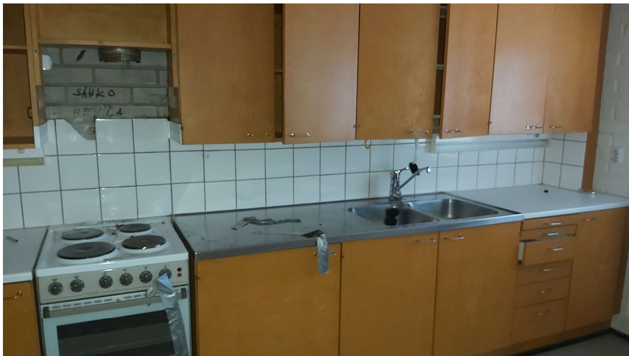
KUVA 12. 51 Keittiö, Seinälaattojen kiinnitys- ja sauma-aine sisältää asbestia (näyte 3).
