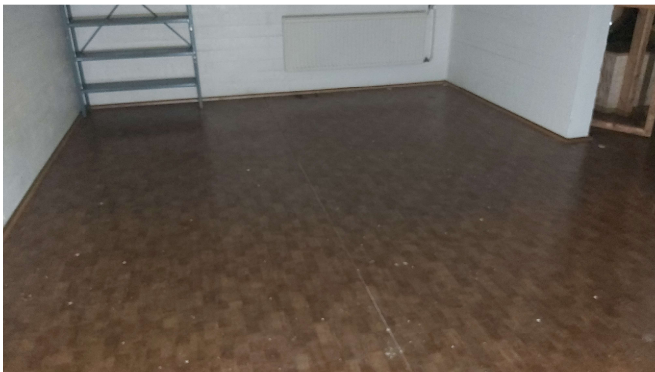
KUVA 4. 1 VSS, Asbestinäyte nro 4, Muovimatto (ruskea) + liima + maali. Ei sisällä asbestia.
